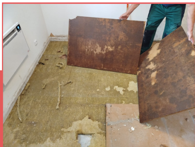
Zničená podlaha, která byla potřeba vytrhat.
